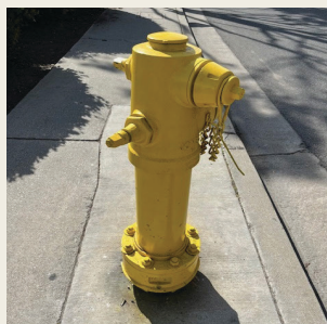
Hidrante con protector
